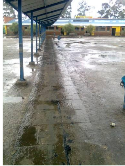
Aspecto de las instalaciones después de evacuar el agua
